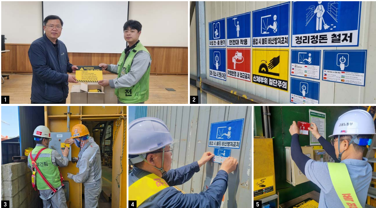
1. 외국인 노동자가 다수 종사하는 사업장에 배포 2. 콘크리트 벽면에도 쉽게 떨어지지 않게 제작된 스티커 3, 4, 5. 안전수칙을 담은 스티커를 실제 현장에 부착
