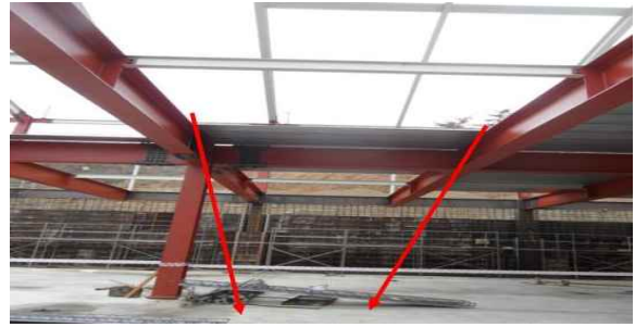
데크 설치 중 7m 아래로 떨어져 2명 사상('14.12.31, 경남 고성)
