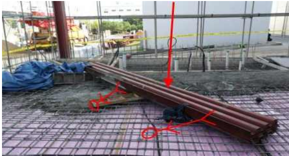
펌프카에 부딪혀 떨어진 데크에 깔려 2명 사망('14.10.3, 전북 완주)
