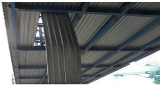
콘크리트 타설 중 데크 탈락으로 2명 사망('16.2.18, 충남 태안)
