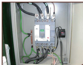
배선용 차단기 거꾸로 설치
